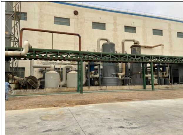
2#车间废气处理措施
