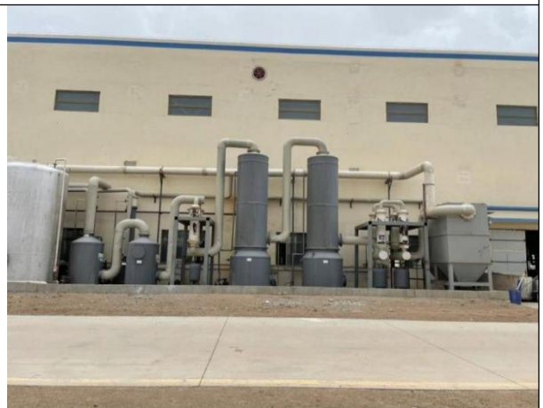
1#车间废气处理措施
